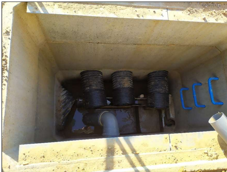
Figure 7 : Système de séparation des jus de silos
